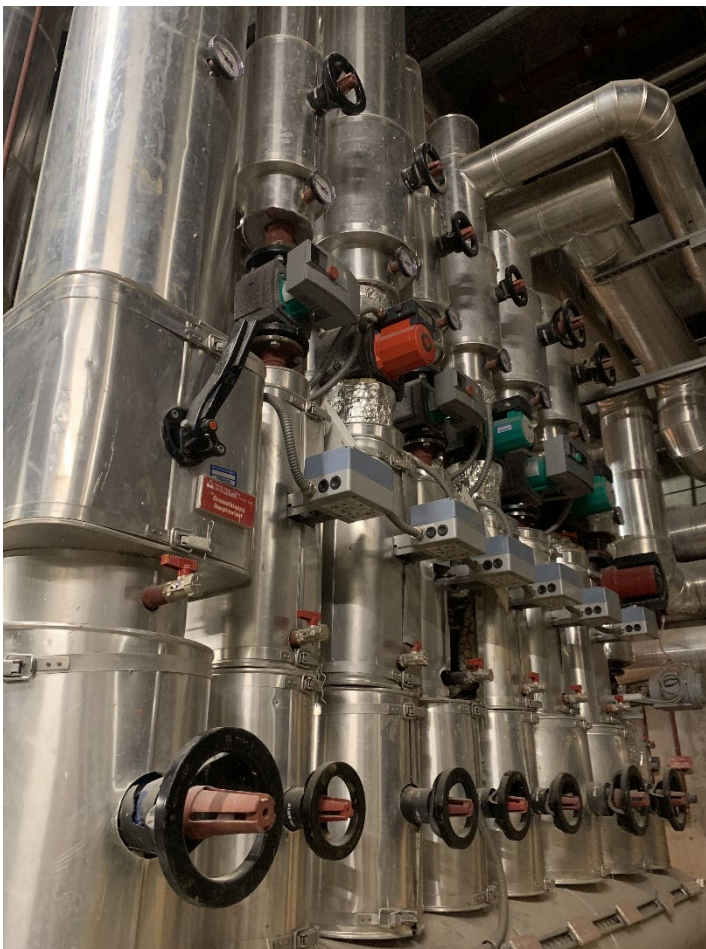
Hinter den Kulissen die komplett erneuerten Badewassertechnik
